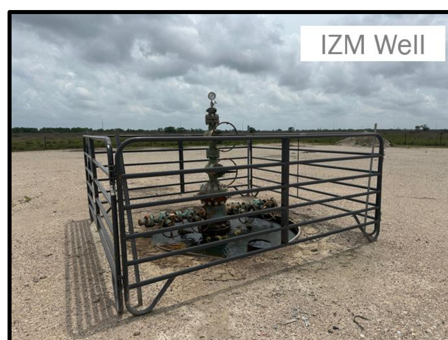
Pozo de monitoreo dentro de la zona: ilustración del tamaño y la huella de la boca del pozo
